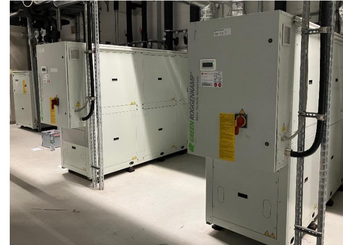
Bild: Wärmepumpen im CMCC
